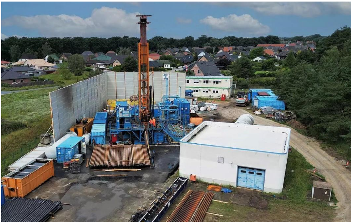
Quelle: ZfK, „Geothermie-Anlage in Neustadt-Glewe wird erweitert“, 3. Aug. 2023, Foto WEMAG/Marschner
